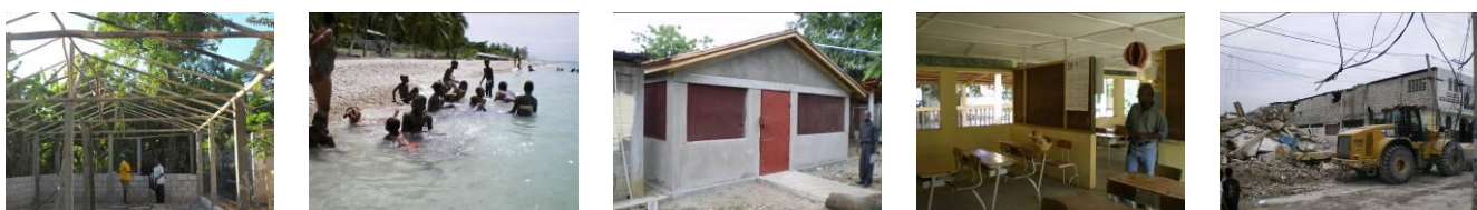
1. Construction d'un poulailler. Ecole Dumarsais., Verrettes. 2. Sortie plage, pour la seconde fois de leur vie, 100 enfants déshérités de Cité Soleil. et Verrettes.3. Construction Ecole Samaritain. Ouanaminthe. 4. Salles de classe Ecole Samaritain. 5. Reconstruction Ecole Sacré Cœur. P. au Prince.
